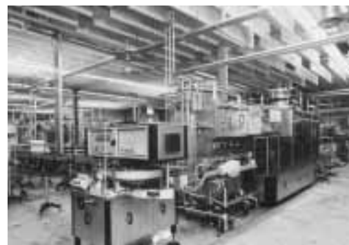
Baffle costituiti da pannelli di lana minerale in una ditta per bibite (impianto di imbottigliamento).
