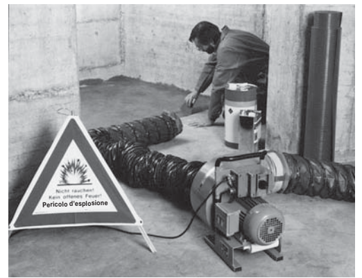
Fig. 5: nelle cantine è indispensabile un'aspirazione artificiale. Se necessario, occorre usare ventilatori portatili.
